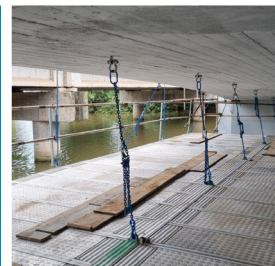
Recuperacao de patologias de pontes
